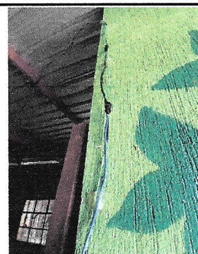
Foto 6: aula no. 3 necesita reposicion de ducto electrico
