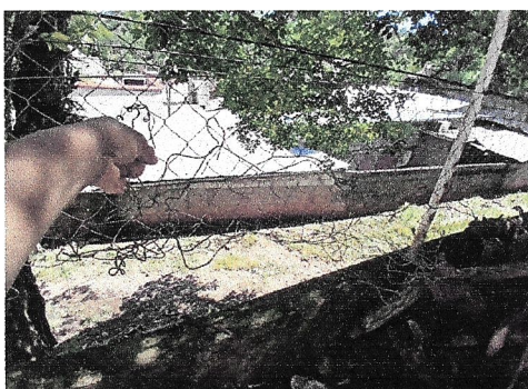
Foto 3: Muro perimetral necesita elevarse dos hiladas de block y sustituir malla
