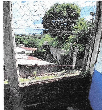
Foto 2: Malla en muro perimetral esta dañada necesita sustitucion por una de mayor altura
