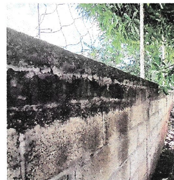
Foto 4: Muro perimetral necesita reposicion de repello para evitar humedad
