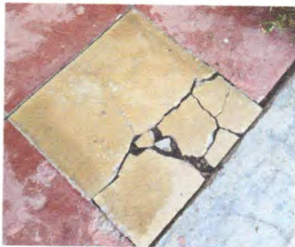
Foto 5: PISO EN CORREDOR
