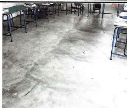
Foto 2: PISO EN AULAS
