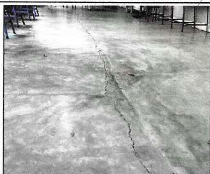
Foto 1: PISO EN AULAS
