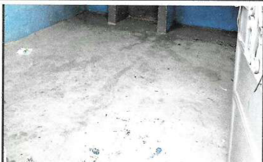
Foto 5: PISO EN COCINA
