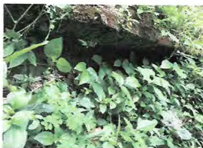
Foto 5: cuneta en mal estado
