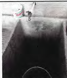
Foto 2: pila en mal estado y ventanas en mal estado
