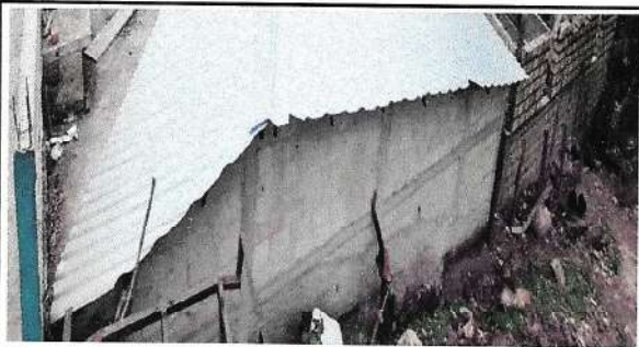
Foto 3: cernido a una parte de la pared donde se filtra agua
