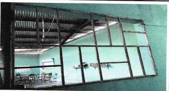
Foto 5: ventanas en mal estado
