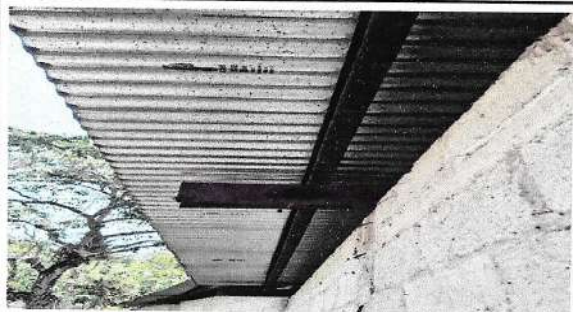
Foto 1: falta de pintura en la estructura de metal
