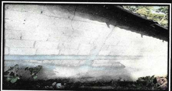
Foto 3: filtración de agua por falta de repello
