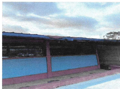
Foto 2: Lámina apachada que no está en las condiciones necesarias.
