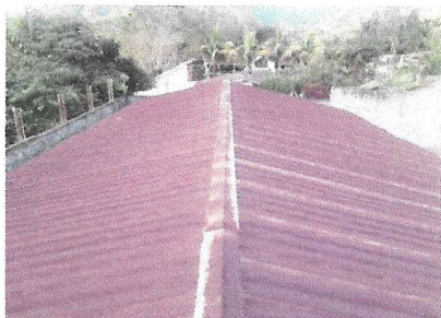
Foto 1: Deterioro de lámina lo que produce demasiada filtración de agua.
