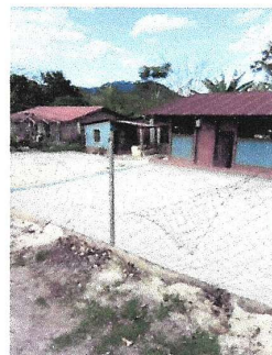
Foto 4: Malla dañada que produce inseguridad al establecimiento.
