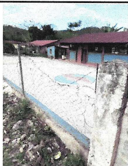
Foto 3: Deterioro de columnas en el muro perimetral propensas a caerse.
