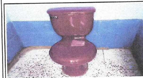
Foto 5: SERVICIOS SANITARIOS Y SUS ACCESORIOS
