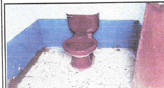
Foto 5: SERVICIOS SANITARIOS Y SUS ACCESORIOS
