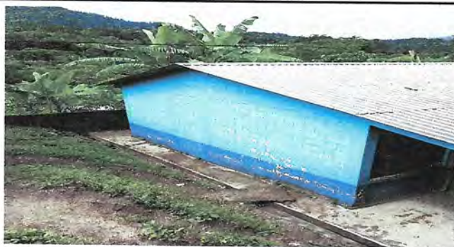
Foto 3: PINTURA EN MUROS PRESENTA DAÑOS
