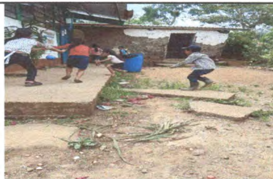
Foto 6: corredor en mal estado.
