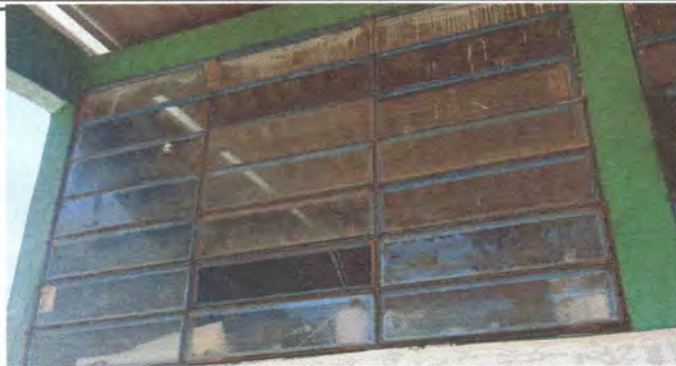
Foto 1: VENTANA FRONTAL Y MARCOS
