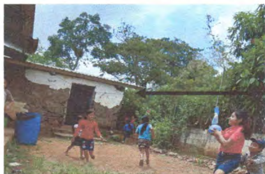
Foto 5: Cableado Eléctrico esta por fuera y hace corto circuito, corredor y patio de la Escuela deteriorado.
