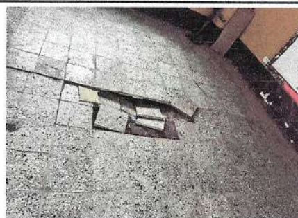
Foto 4: Hundimiento del piso en el salón de clases
