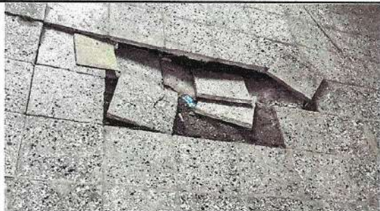
Foto 1: Hundimiento de piso en el salón de clase
