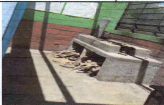
Foto1: Chimenea de cocina
