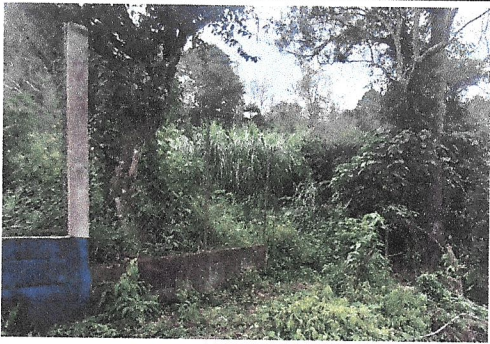
Foto 3: Malla de muro perimetral deteriorada
