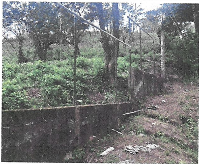
Foto 4: Muro perimetral en malas condiciones
