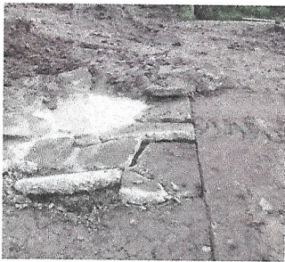
Foto1: plancha de concreto deteriorada
