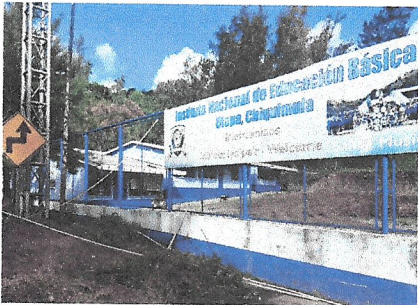
Foto 6: Pintura deteriorada del muro perimetral
