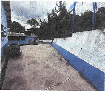
Foto 5: Pintura deteriorada del muro perimetral
