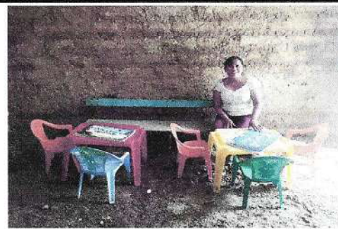
foto 6: Losa de cemento
