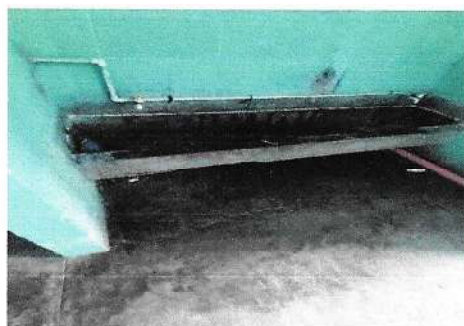
Foto 5: BAÑOS EN MAL ESTADO
