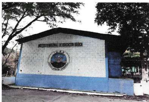
Foto 1: MURO DE AULA
