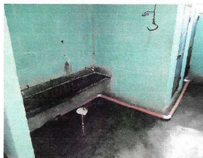
Foto 4: BAÑOS EN MAL ESTADO
