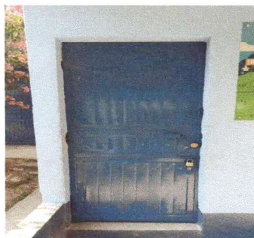
Foto 2: Sustrucción de puerta de aula
