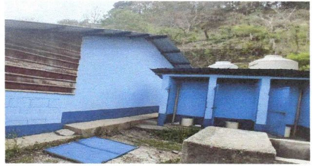
Foto 4: Sustrucción de puerta de módulo de baños.
