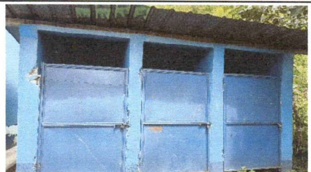
Foto 4: Sustrucción de puerta de módulo de baños.
