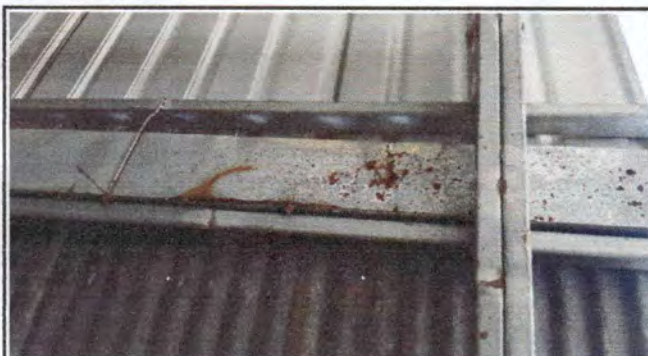
Foto 3: Canales del agua pluvial dañados.
