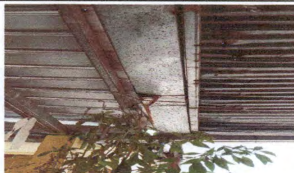
Foto 4: canales y bajada de gua pluvial con deterioro.
