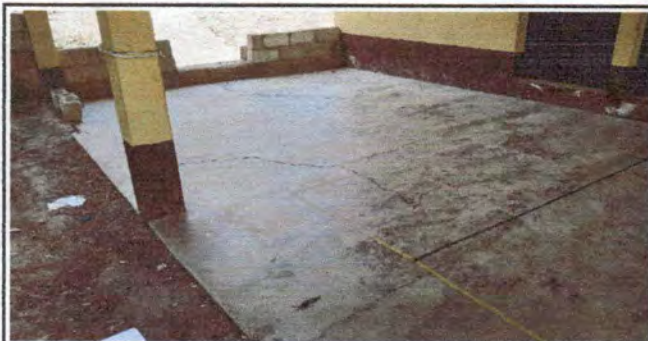
Foto 5: Estado actual del piso de la escuela.
