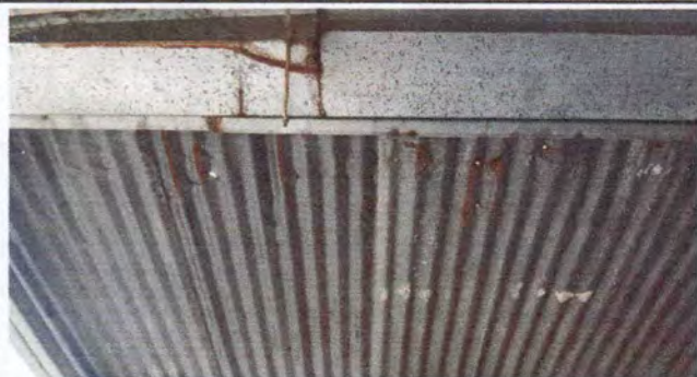
Foto 1: Lámina dañada del salón de clases de la escuela.
