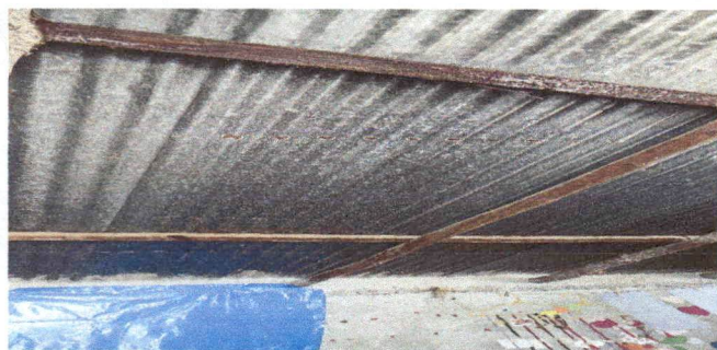
Foto 5: Lamina en mal estado
