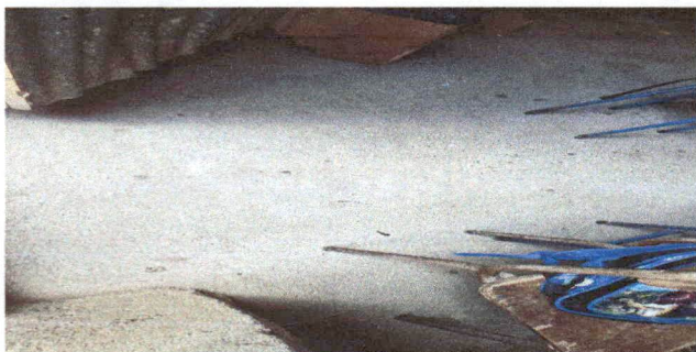
Foto1: Piso en mal estado
