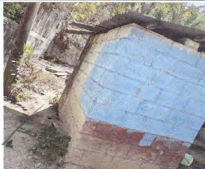
FOTO 10. Sustrucción de lámina troquelada en baño
