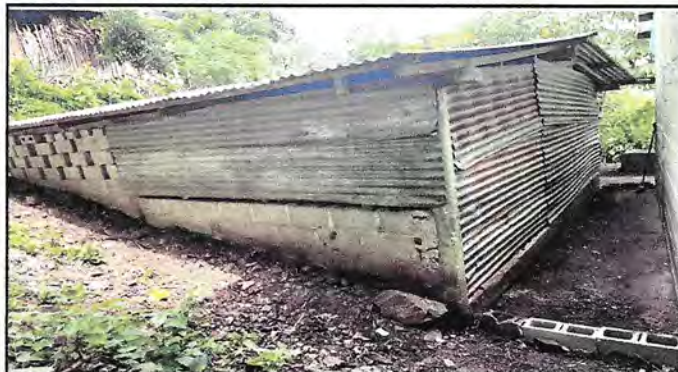
Foto 1: solo se observa la columna de la pared No.1 debido a que se destruye la pared anterior por seguridad de los niños
