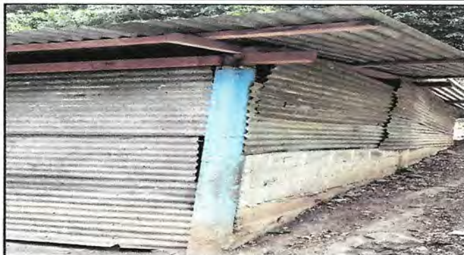
Foto 2: solo se observa la columna de la pared No. 2 y una parte de pared en mal estado, debido a que destruye la pared por seguridad de los niños
