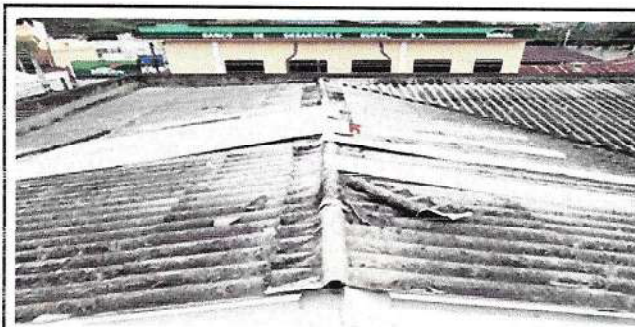
Foto 5: Techo deteriorado del edificio educativo
