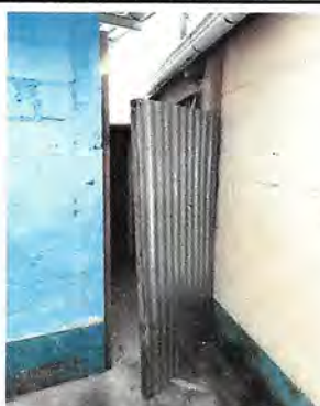
Foto 3: Sustrucción de puerta en servicios sanitarios
