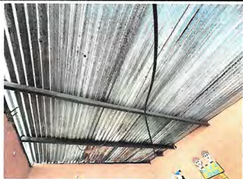
Foto 1: Sustrucción de lámina de aulas
