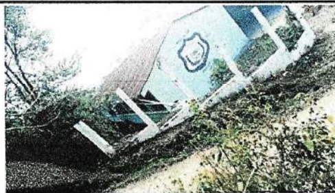
Foto 5: cubierta de lamina y pintura en mal estado
