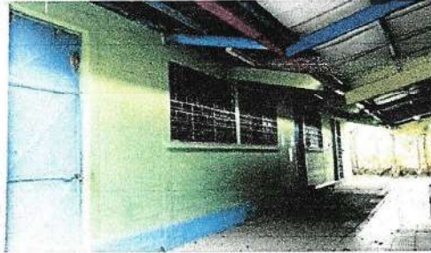
Foto 4: pintura de puertas en mal estado
