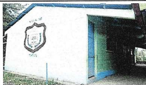
Foto 2: pintura en mal estado
