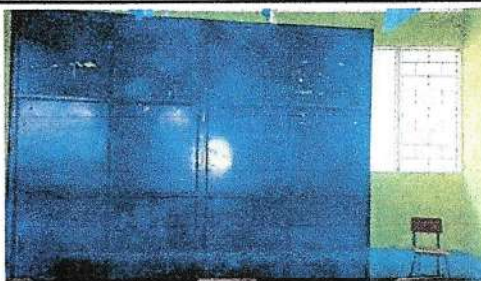
Foto 6: portones en mal estado
