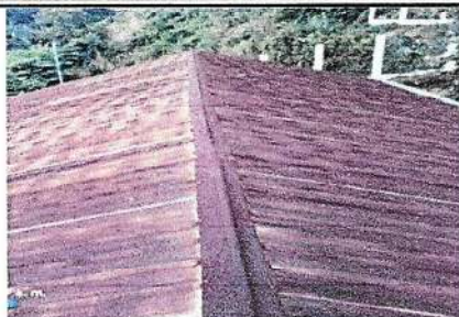
Foto 1: cubierta de lamina en mal estado
