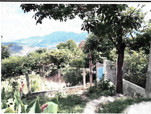
Foto 2: MURO EXISTENTE EN MAL ESTADO
