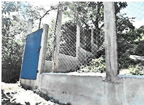
Foto 4: MURO EXISTENTE EN MAL ESTADO
