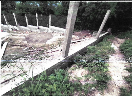
Foto 4: MURO EXISTENTE EN MAL ESTADO
