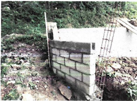
Foto 2: MURO EXISTENTE EN MAL ESTADO
