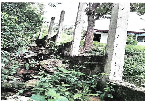
Foto 4: MURO EXISTENTE EN MAL ESTADO
