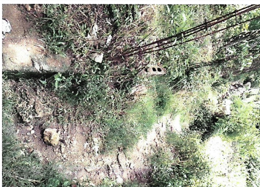
Foto 2: MURO EXISTENTE EN MAL ESTADO
