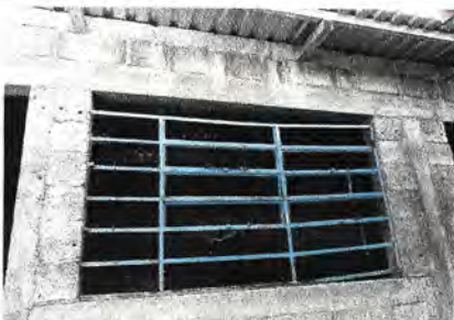
Foto 3: Sustrucción de ventanas 1.25 X 2.00 metros. El estado de las ventanas se encuentra en mal estado e inseguro para las y los estudiantes.
