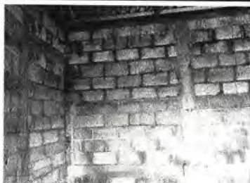
Foto 5: Reparación de 363 metros de repello y cernido en paredes. La presentación de las paredes de la escuela no son las ideales para un centro educativo.
