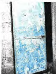
Foto 2: Sustrucción de puertas de 1.00 x 2.00 metros. Las puertas de las aulas se encuentran en malas condiciones y no ayuda a tener un ambiente seguro.
