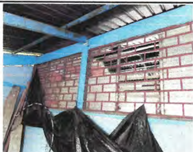
FOTO3. VENTANAS EN MAL ESTADO, NECESITAN SER SUTITUIDAS
