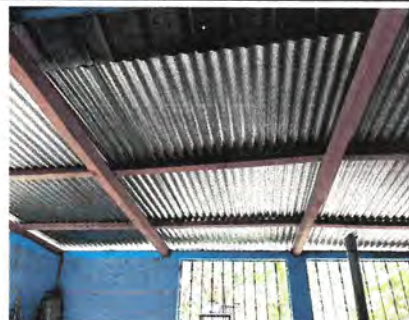
FOTO 2. CUBIERTA DE LAMINA EN MAL ESTADO DE COCINA
