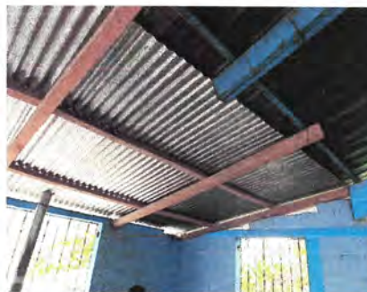
FOTO 4 . ESTRUCTURA DE TECHO EN MAL ESTADO
