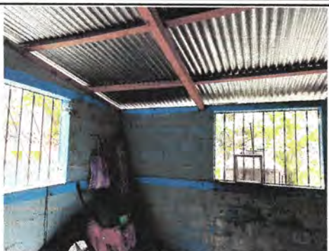
FOTO 1. REPELLO DE PAREDES EN COCINA ESTA EN MAL ESTADO
