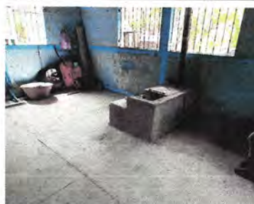
FOTO 6. LA ESTUFA EXISTENTE SE ENCUENTRA EN MAL ESTADO Y NECESITA REFUERZO Y MANTENIMIENTO
