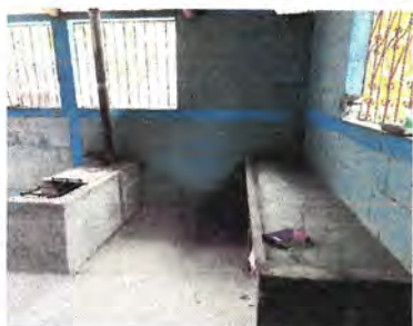
FOTO 5. EL MESON Y GABINETE EXISTENTE DE LA COCINA NECESITA MANTENIMIENTO EN LA ESTRCUTURA DEBIDO A QUE EL ACTUAL ESTA DAÑADO Y PRESENTA DAÑOS POR EL PASO DEL TIEMPO Y USO
