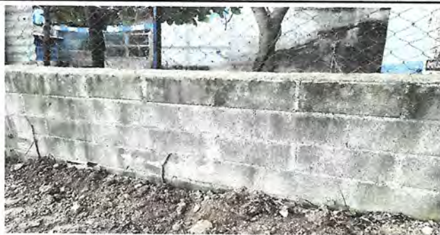
Foto 3: LIMITE DEL MURO PERIMETRAL QUE FUE DESTRUIDA POR LA CORRIENTE DE LLUVIA QUE AFECTO EL ÁREA DE PÁRVULOS
