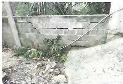
Foto 2: MURO PERIMETRAL DE LA ESCUELA DE PÁRVULOS DESTRULLO EN SU TOTALIDAD POR LA CORRIENTE DE LLUVIA
