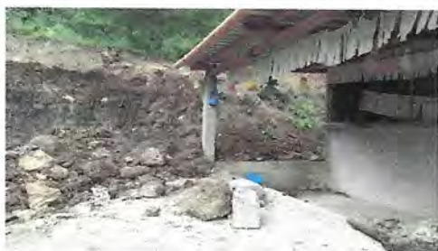
Foto 1: DESTRUCCIÓN DEL MURO PERIMETRAL POR LA LLUVIA QUE AFECTO EL ÁREA
