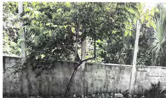
Foto 4: ESTO ES EL LARGO DEL MURO QUE CUBRILLA LA ESCUELA EODP TESORO ARRIBA
