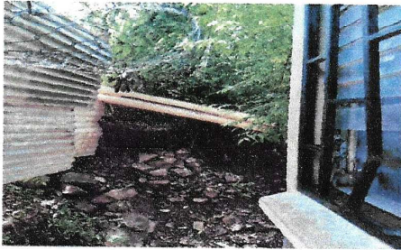
Foto 1: Como se observa, las bases construidas se encuentran en el aire debido al movimiento de tierra
