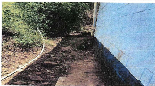
Foto 3: Parte de atrás del centro educativo donde se verifica los daños provocados por el movimiento de tierra.
