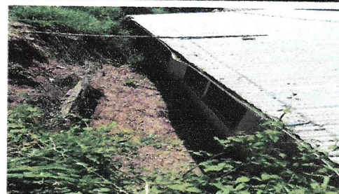
Foto 2: En la imagen se refleja la destrucción del muro anterior debido al peso de la tierra.
