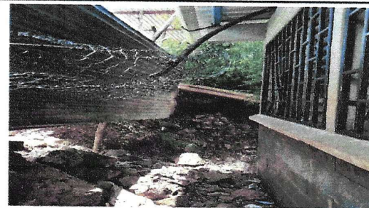
Foto 4: De esa forma se encuentra la maya que contenía el muro anterior del cual se quitó debido a que amenazaba con destruir la pared de la escuela por el peso de la tierra.
