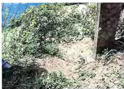
Foto 3: Malla galvanizada despegada del suelo.
