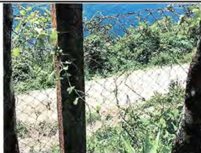
Foto 5: Malla galvanizada en mal estado.
