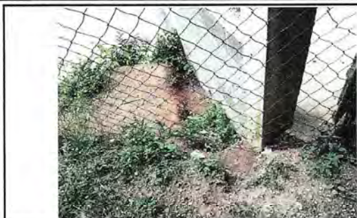
Foto 1: Malla galvanizada despegada.
