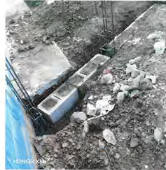
Foto 2: muro existente en la parte frontal de la cocina, necesita seguimiento y continuar
