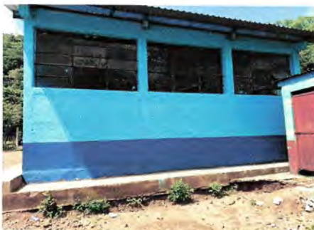
Foto 5: Mantenimiento a ventanas en mal estado
