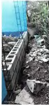
Foto1: muro existente en area de cocina, necesita seguimiento para mejorar estas paredes de cocina
