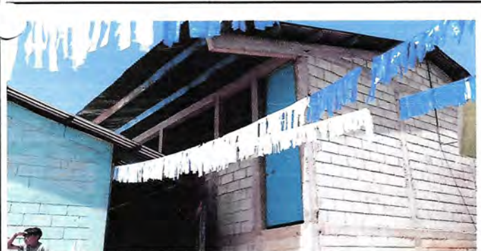
Foto 5: Techo en mal estado
