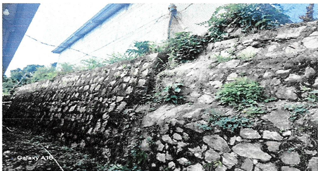
Foto 4: De esa forma se encuentra el muro sin columnas que permite soportar el peso de las aulas.
