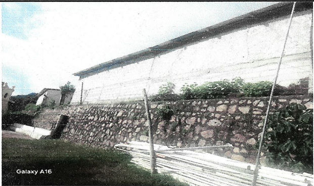
Foto1: Como se observa, las bases construidas se encuentran en el aire debido el tiempo se a deteriorado
