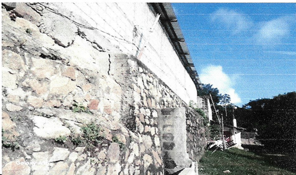
Foto 2: En la imagen se refleja la inseguridad que binda el muro de tontencion
