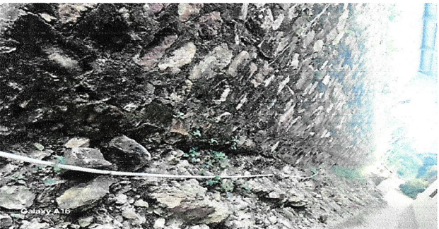
Foto 3: Es evidente que el simiento del muro de contencion esta muy dañado a punto de colapsar.
