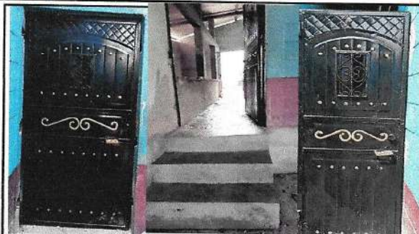
Foto1: Sustrución de Puerta
