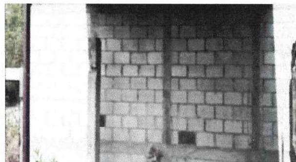
Foto 4: Repello en muro, sellado de grietas
