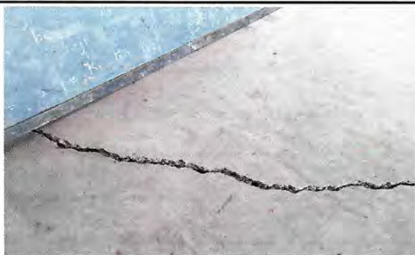
Foto 3: Piso de concreto que muestra grietas
