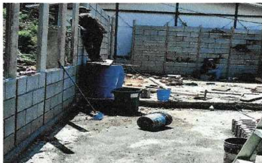
Foto 1: Area de Comedor y Cocina Postes sembrados con cemento que ya estaba de construccion anterio.
