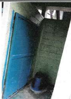
Foto 6: Baños de fosa septica.
