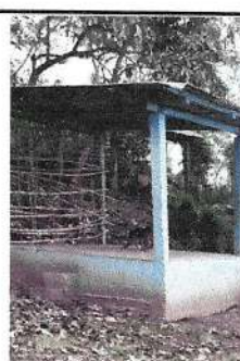
Foto 6: otro ángulo del escenario donde se le coloco varitas atrás para colcoar materiales didácticos de las diferentes actividades que se realizan en el establecimiento, se necesita reforzar la estructura y mejorar la cubierta del techo
