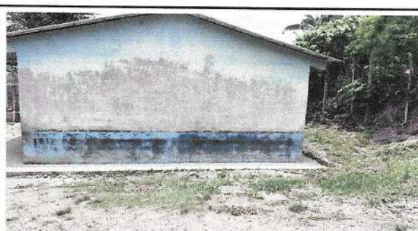
Foto 4: pintar nuestra escolita, mejorara la presentación. Por lo se observa que las paredes estan deterioradas.
