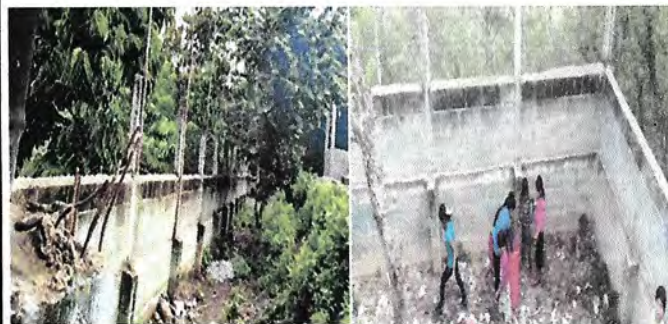
El muro de contención esta dañado.
