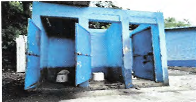
Las puertas y los sanitarios se encuentran en malas condiciones.
