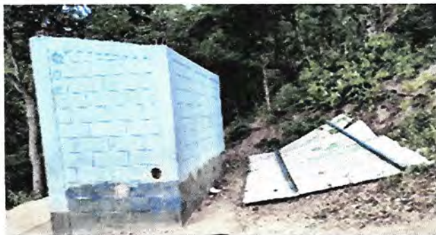
El techo de los sanitarios esta dañado.
