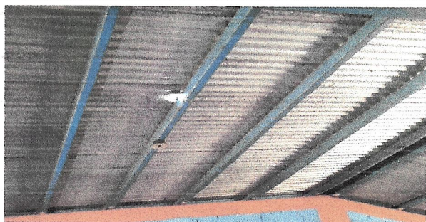
Foto 1: TECHO DAÑADO DE AULA 1, SE CAMBIARÁ LÁMINA
