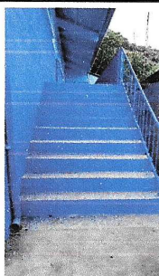
Foto 3: estado actual de barranda de gradas
