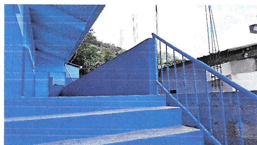
Foto 4: estado actual de barranda de pasillo
