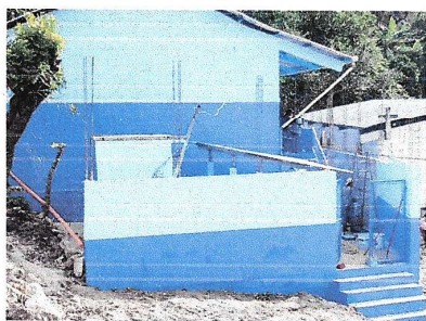
Foto 5: estado actual de muro
