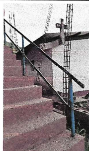
Foto 3: estado actual de barranda de gradas
