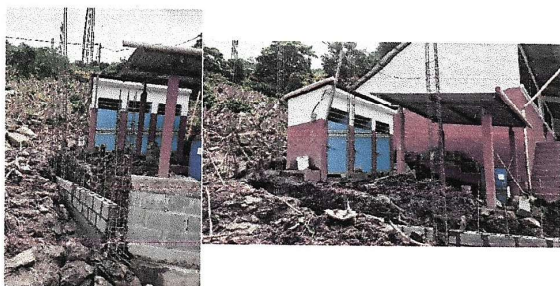
Foto 5: estado actual de muro
