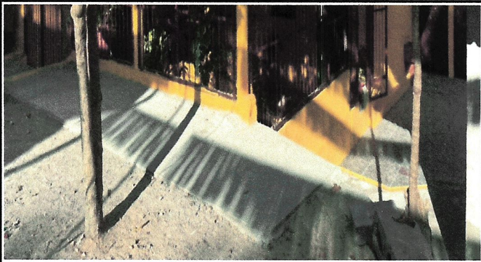
Foto7: SEGUIMIENTO DE LOSA DE PATIO EXISTENTE, PRODUCE LODO Y ES PELIGRO PARA ESTUDIANTES
