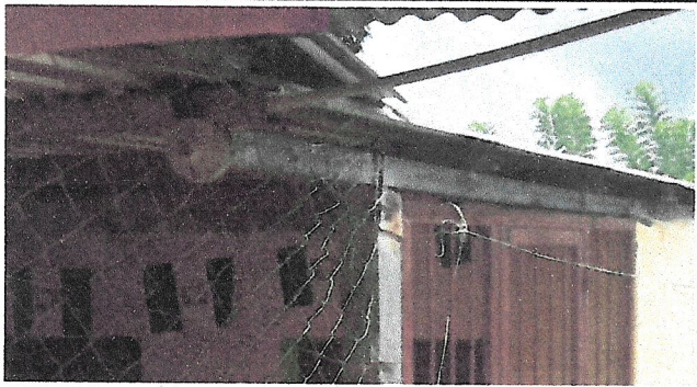
Foto1: CUBIERTA DE TECHO EN MAL ESTADO
