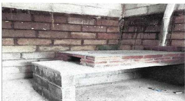
Foto 4: Estufa Rural y Torta de Concreto
